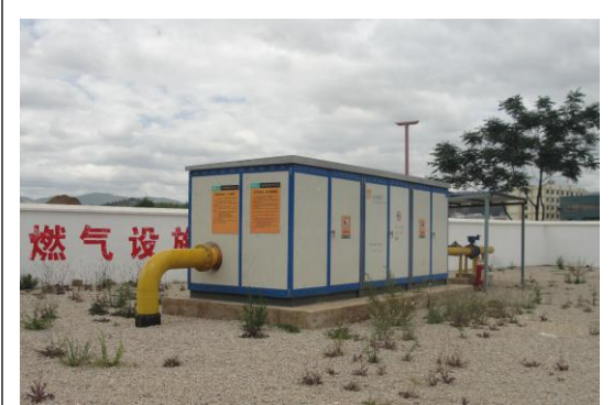
调压站工艺区
